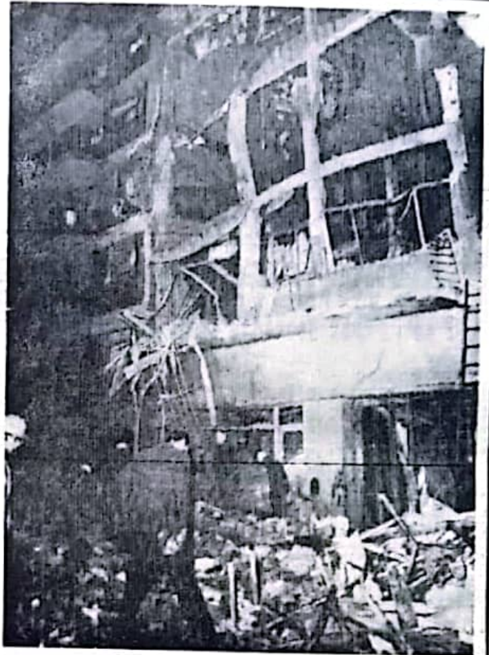
Una vista parcial del edificio lindante al de Lambruschini, en el que fue colocado el explosivo, el que fue destruido completamente desde su planta baja hasta el cuarto piso por la onda expansiva. (Radiofoto de N. A.) —
